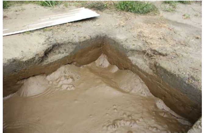
圖 65：TP1 東、北牆疑似畦溝現象土層崩落
